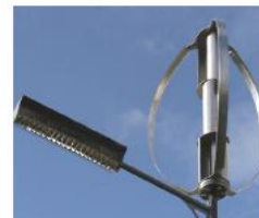
Le lampadaire éolien comporte son propre système d'alimentation
